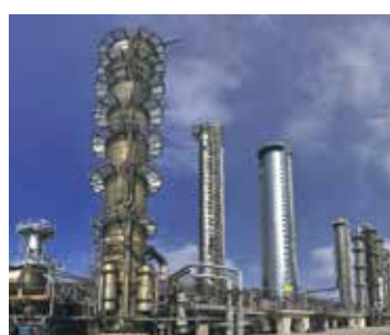
INSTALACJA DESTYLACJI CYKLOHEKSANONU, AZOTY TARNÓW
